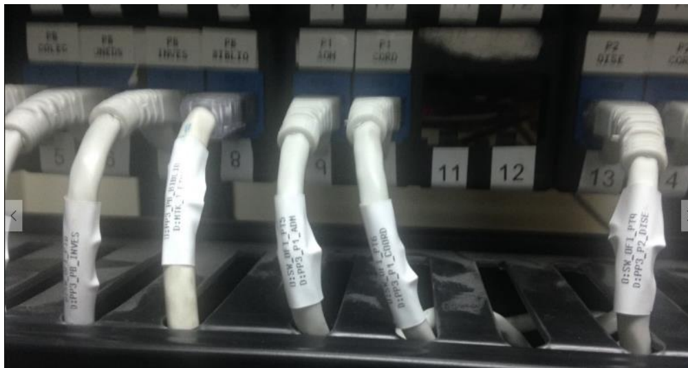
Figura 34: Etiquetado de Cableado Oficinas
