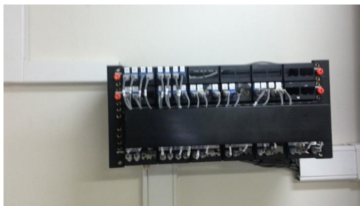
Figura 26: Conexión de Puntos Patch Panel
