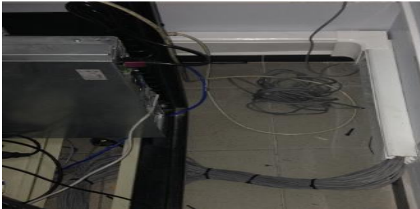
Figura 16: Paso Cableado (Oficina Departamento de Sistemas)
