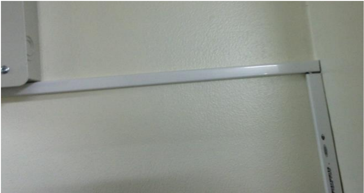
Figura 20: Paso Cableado Eléctrico 1
