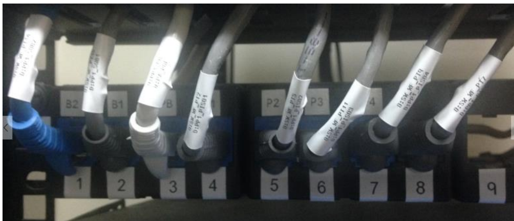
Figura 30: Etiquetado de cableado Wifi
