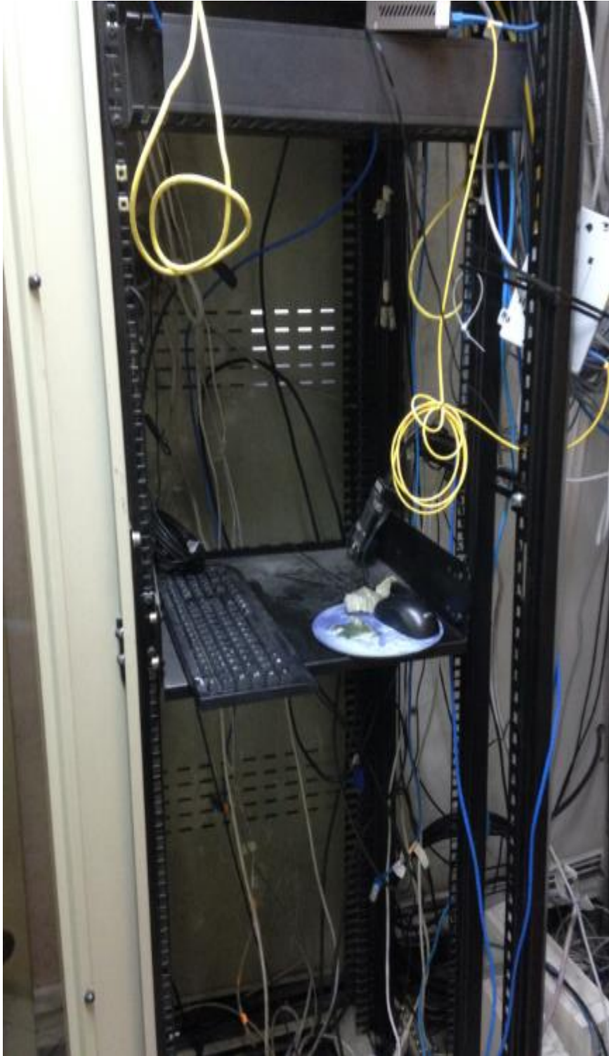
Figura 24: Desconexión de Equipos Rack Servidores
