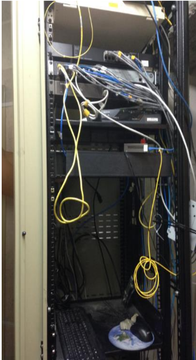
Figura 23: Desconexión de Equipos Rack Equipos Comunicación
