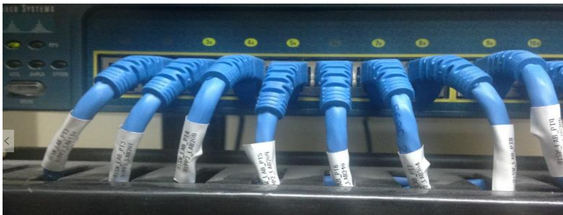
Figura 32: Etiquetado de Cableado Laboratorios
