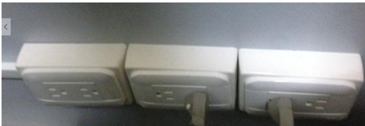
Figura 22: Tomas de Energía (Otro Angulo)
