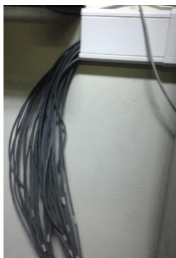
Figura 15: Paso Cableado (Oficina Director de Carrera)
