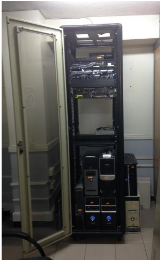
Figura 28: Rack Nueva Ubicación (Departamento de Sistemas)
