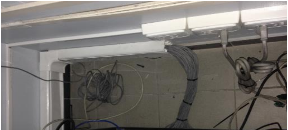
Figura 21: Tomas de Energía
