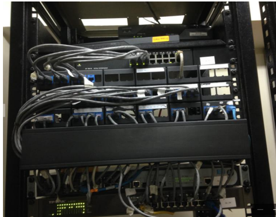
Figura 27: Conexión nuevos puntos en la nueva posición Rack
