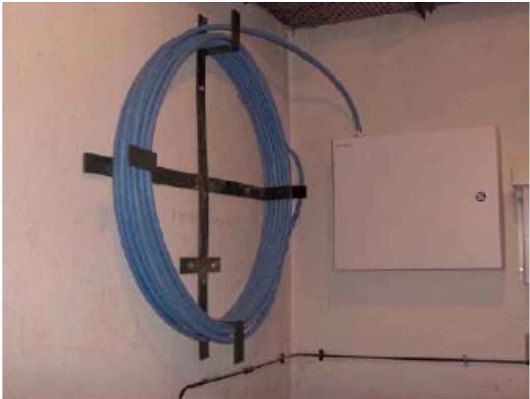
Figura 2.42 Porta reservas en galería de cables
