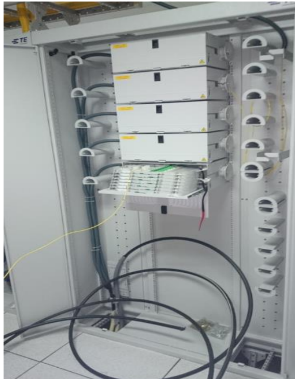
Figura 2.30 Rack de ODF's de una de las OLT de la CNT EP
