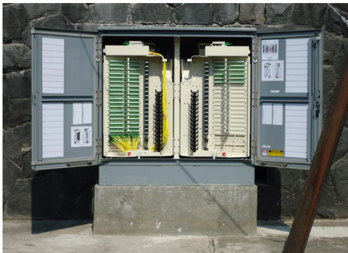
Figura 2.34 Armario GPON - FDH, instalada con su respectiva base.
