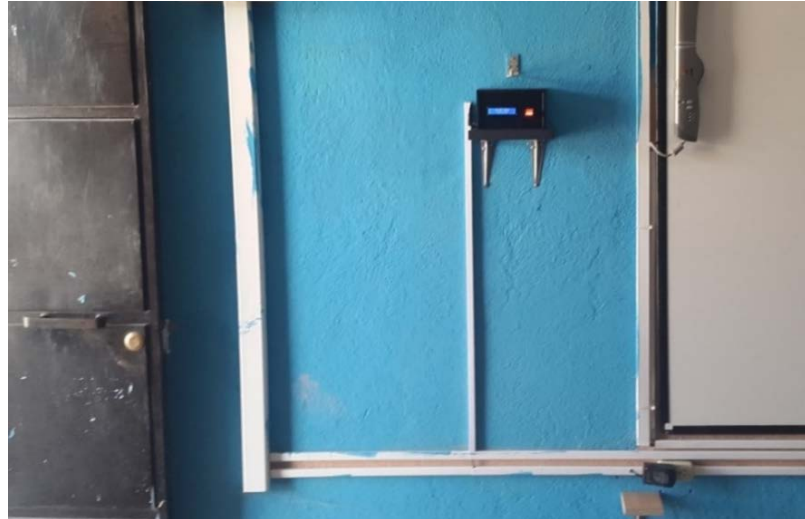
Figura 32. Instalación del reloj biométrico fabricado.
