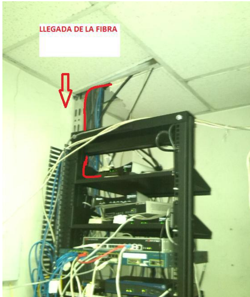
Fig. 3.19. Cuarto de equipo – Cliente.
