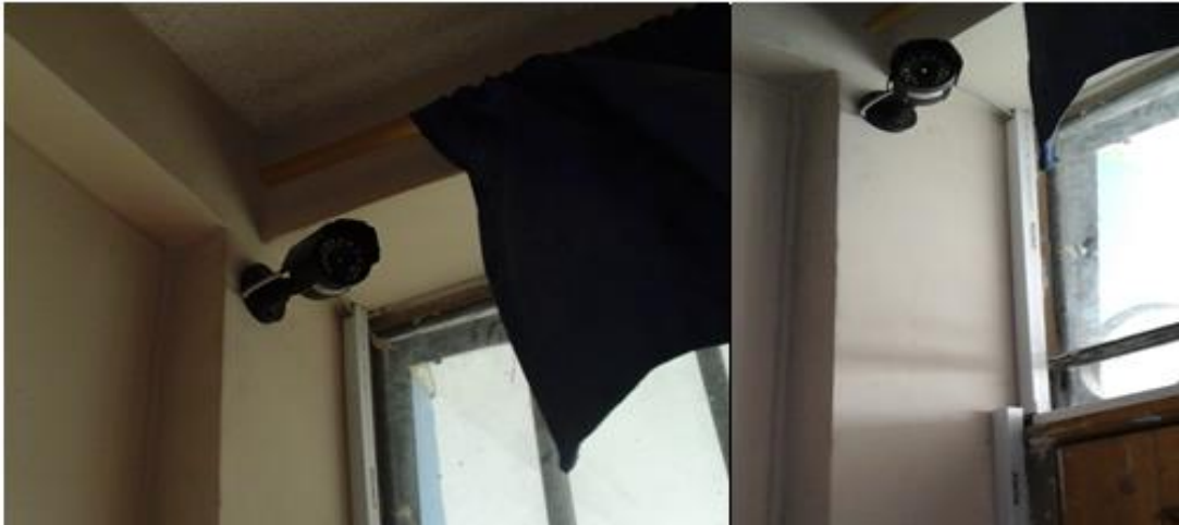
Figura 44. Cámara 3 ubicada en el interior del laboratorio con vista al rack de equipos. Fuente: Unidad Educativa Luxemburgo.
