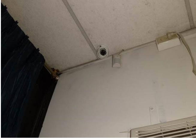
Figura 28. Cámara tipo domo ubicada en el extremo interior de la sala de audiovisuales de la escuela.
