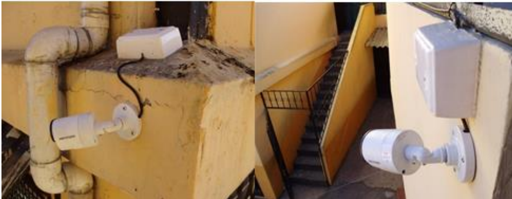
Figura 29. Cámaras tipo bala ubicadas en los exteriores de la sala de audiovisuales de la institución educativa.
