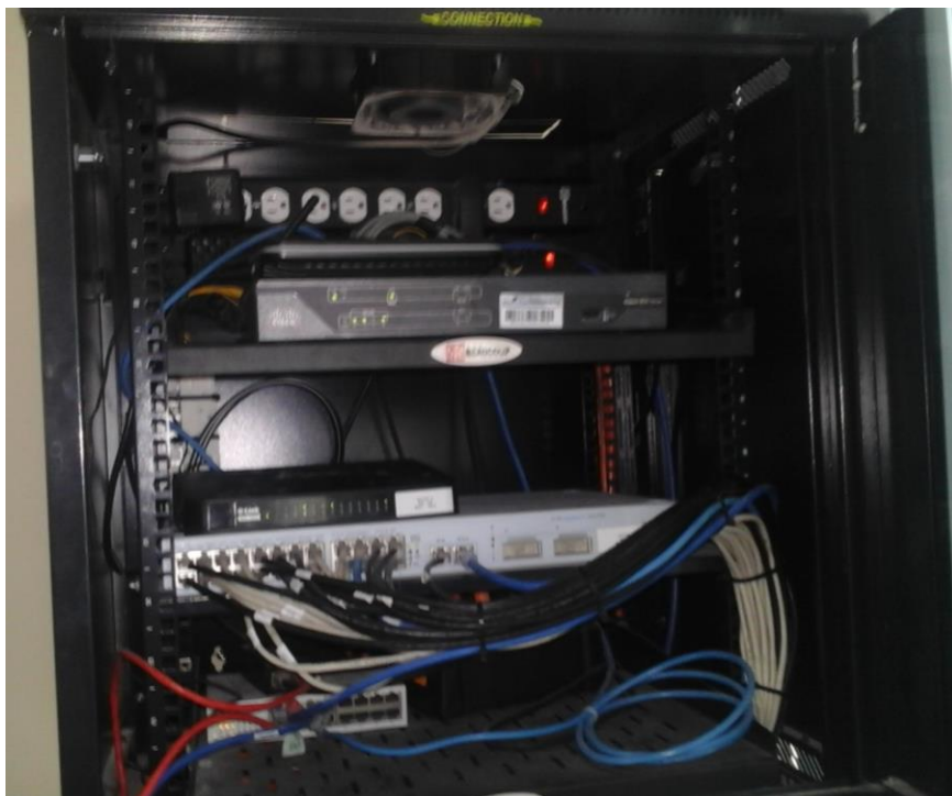
Rack ubicado en el laboratorio de computación donde están alojados los dispositivos que interconectan la red LAN privada.
