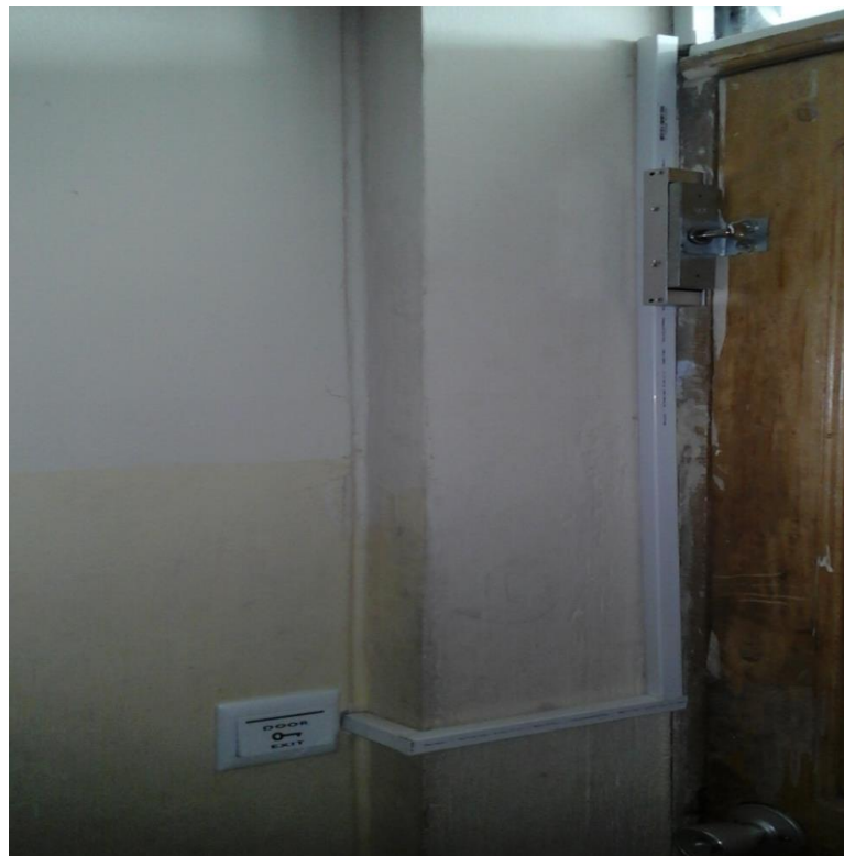
Sistema de desactivación manual terminada.
