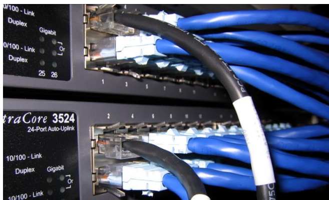
Figura 27. Conexiones a puertos Ethernet del Switch.
