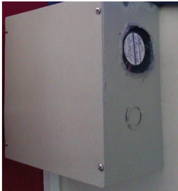
Vista lateral del tablero de control Arduino.
