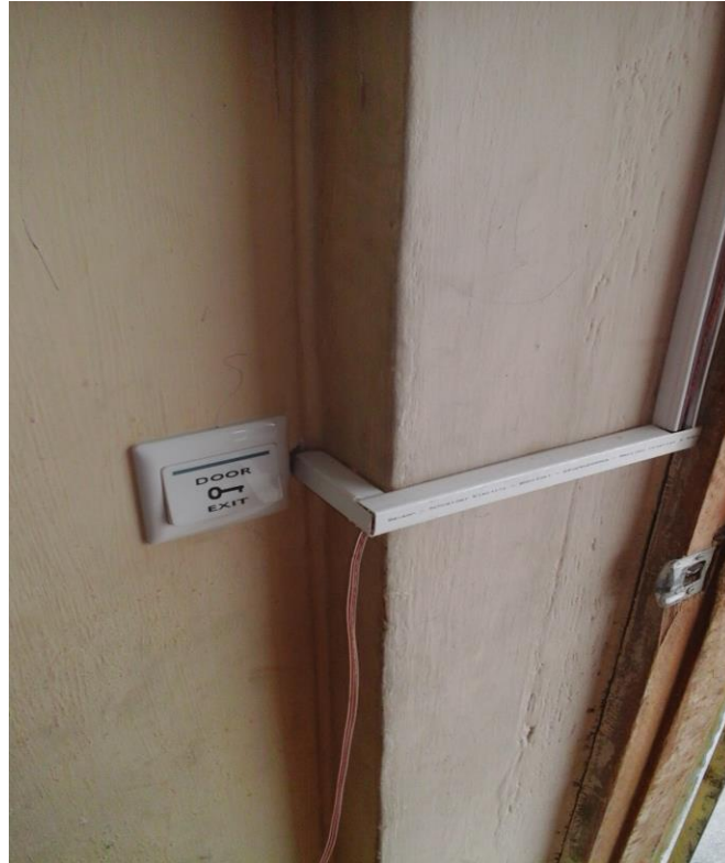
Colocación del pulsador manual para la cerradura electromagnética.
