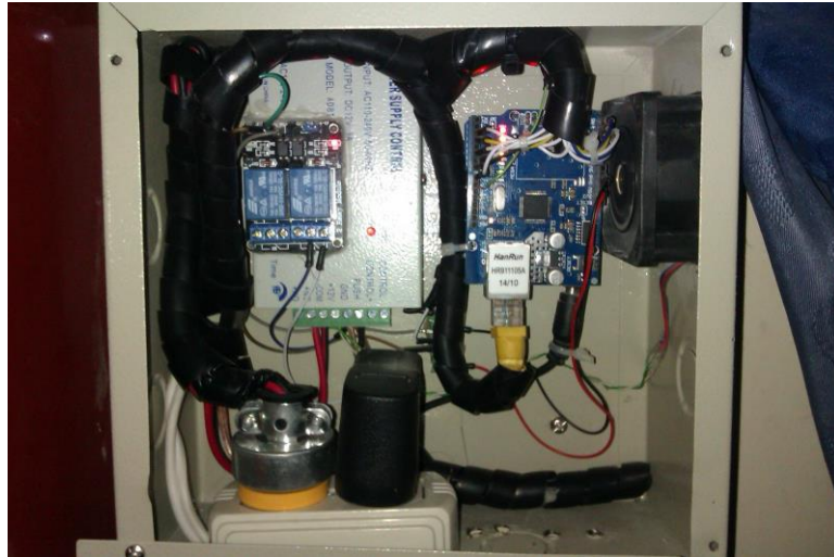
Caja de alojamiento del sistema de control de acceso.
