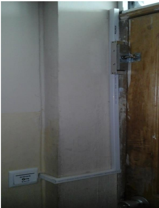
Figura 54. Cerradura electromagnética instalada en la puerta de acceso del laboratorio con el pulsador de apertura.
