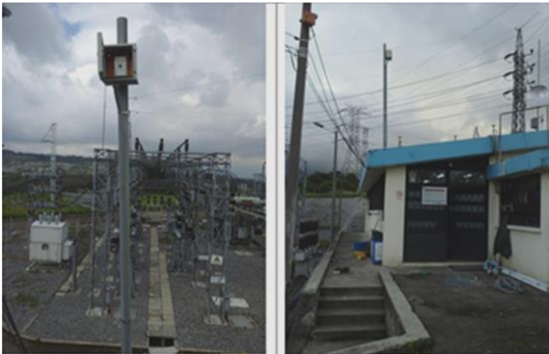
Figura 22. Cámara exterior 1 instalada
