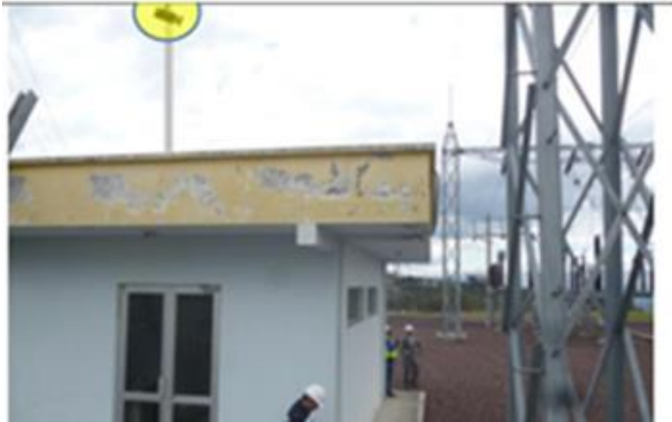
Figura 24. Cámara exterior 3 instalada
