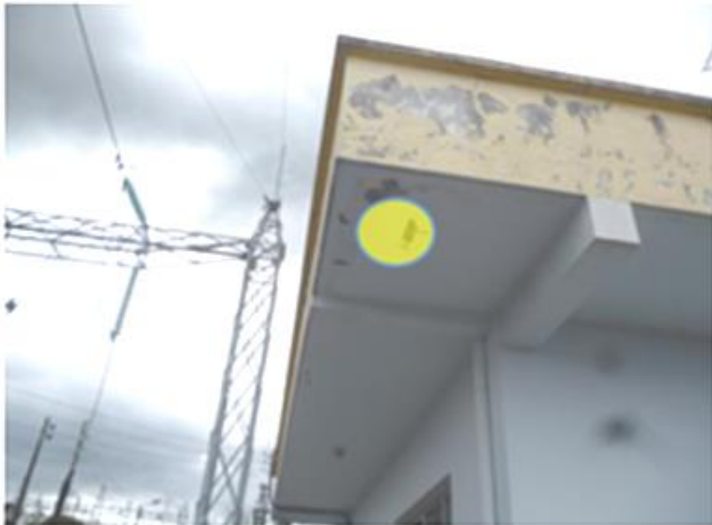
Figura 23. Cámara exterior 2 instalada
