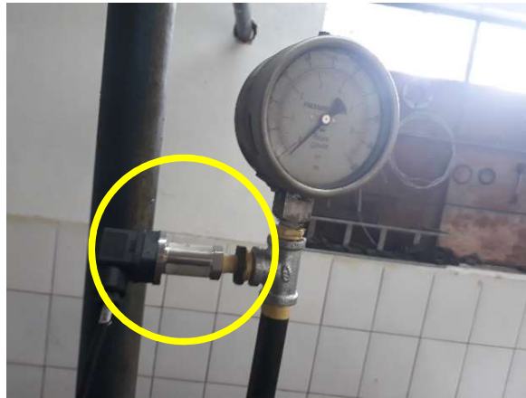
Figura 69 Sensor de presión sistema de ingreso de agua
