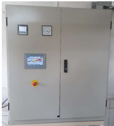
Figura 73 Vista frontal del tablero de control Fuente: Elaborador por el Autor
