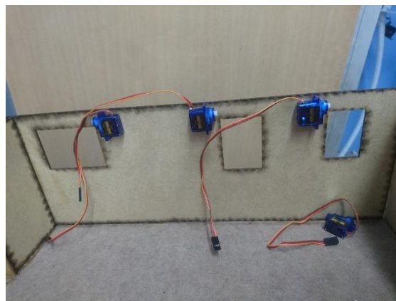
Figura 84 Instalación de Microservomotores para accionamiento de persianas
