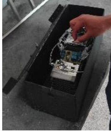
Figura 69. Colocación e instalación de los dispositivos en el interior de la caja de protección.
