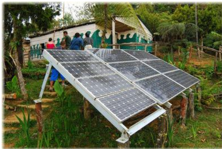
Figura. 1.4. Sistema Fotovoltaico autónomo
