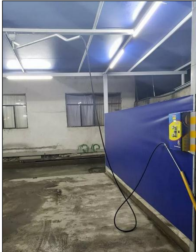
Figura 18. Pista de lavado instalada
