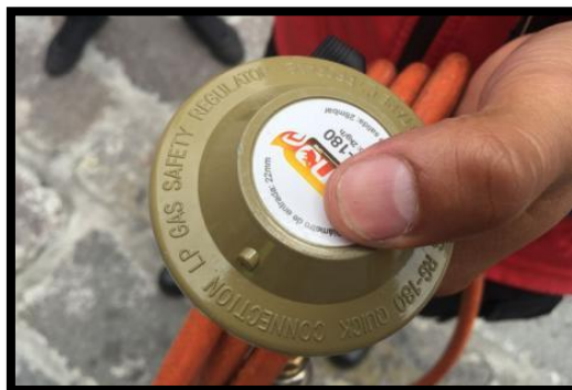
Figura. 1.2. Verificación de válvulas, mangueras y cilindros
