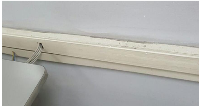
Figura 21: Canaletas de conexión
