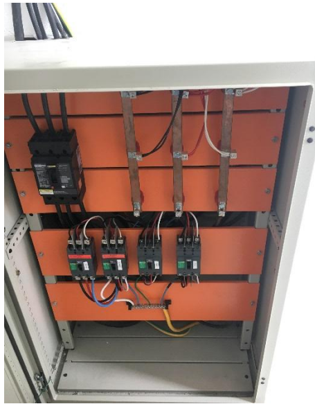
Imagen 3: Tablero de alimentación 220v
