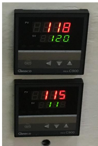
Imagen 7: Posición controladores de temperatura
