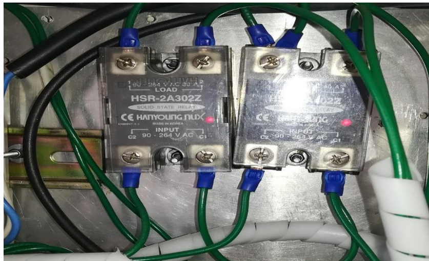
Figura 4.19. Relés de estado solido Fuente: Elaborado por el autor
