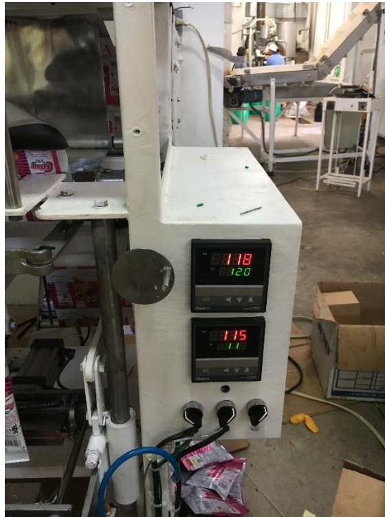
Imagen 9: Parte Exterior del Tablero
