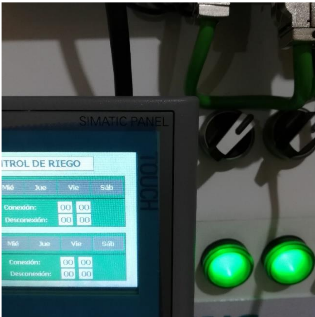
Fig. 4.26 Pruebas de funcionamiento manual del sistema de control temporizado Fuente: (Elaborador por el autor)
