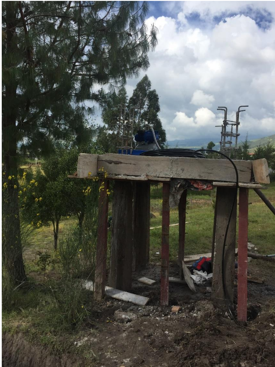
Fig. 4.8 Estructura para colocación de cisterna y bomba eléctrica Fuente: (Elaborador por el autor)
