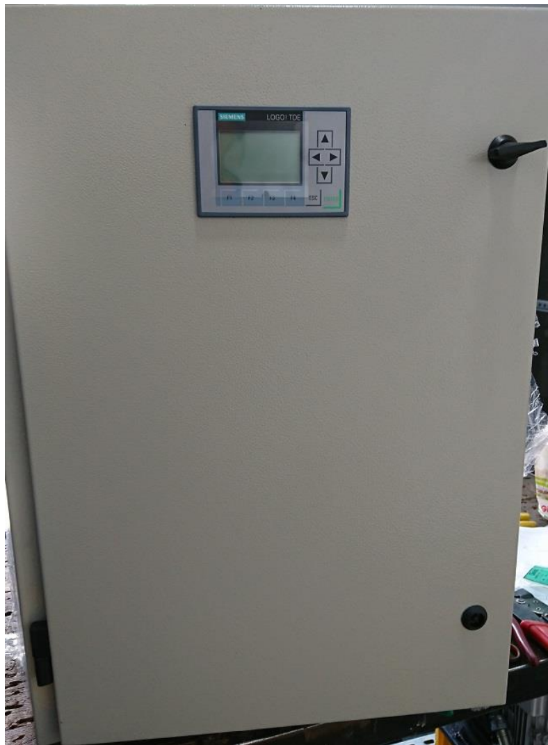
Fig. 4.23 Montaje de display en puerta de tablero principal Fuente: (Elaborador por el autor)
