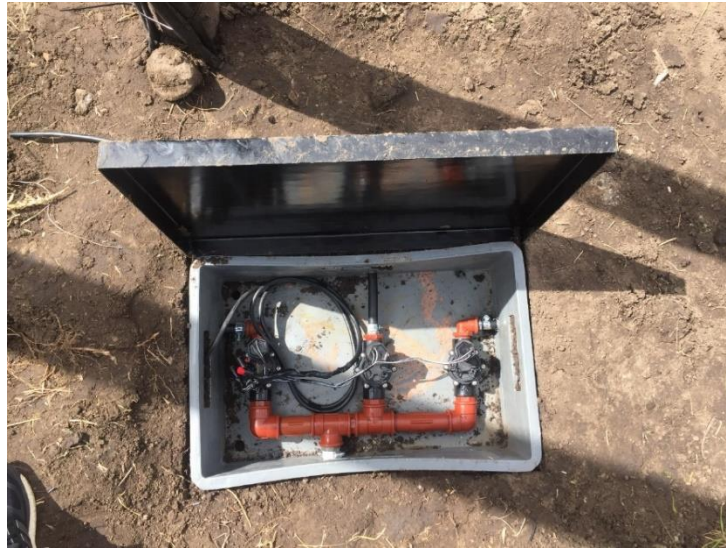
Fig. 4.4 Instalación de electroválvulas Fuente: (Elaborador por el autor)
