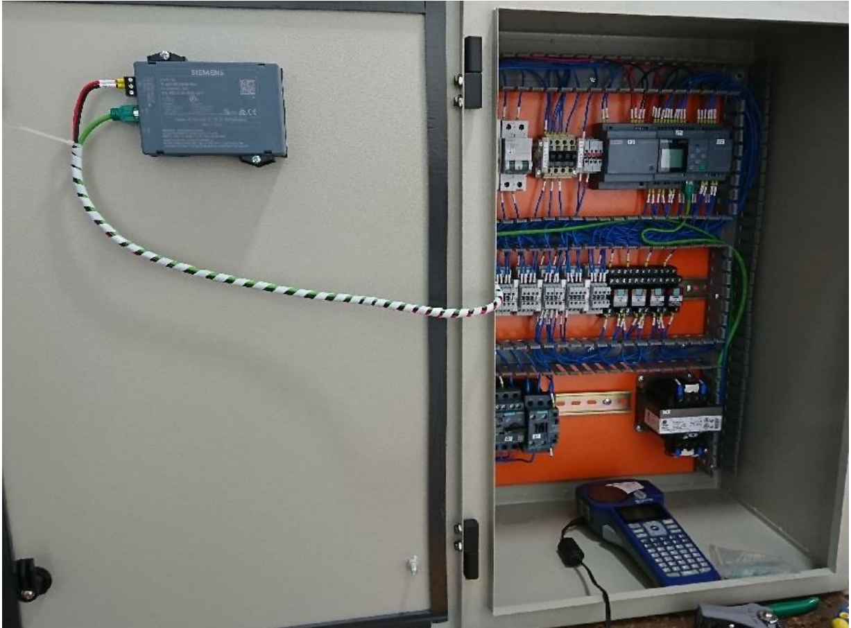
Fig. 4.24 Etiquetado del tablero de acuerdo al plano de control Fuente: (Elaborador por el autor)
