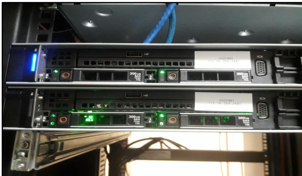
Figura 62. Colocación equipo gateway 1 y equipo gateway 2 en el DC El Telégrafo
