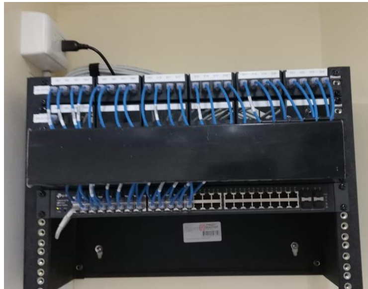
Figura. 4.15. Estado Final del Rack Fuente: Elaborado por el Autor
