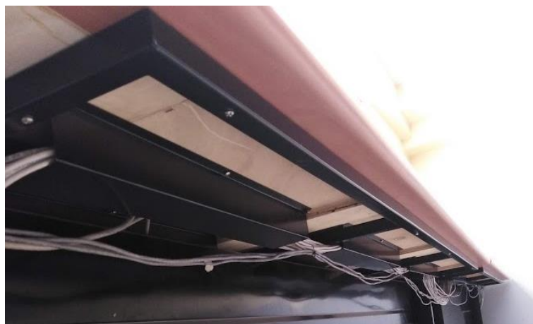
Figura. 3.2. Estado del Cableado Fuente: Elaborado por el Autor
