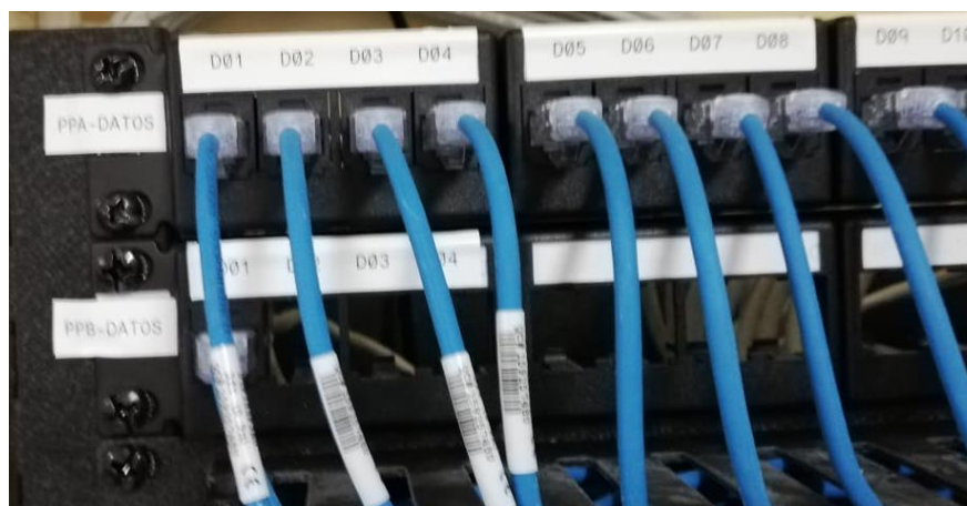
Figura. 4.14. Etiquetado del Patch Panel
