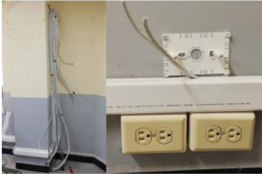
Figura. 4.11. Cableado Preliminar Fuente: Elaborado por el Autor
