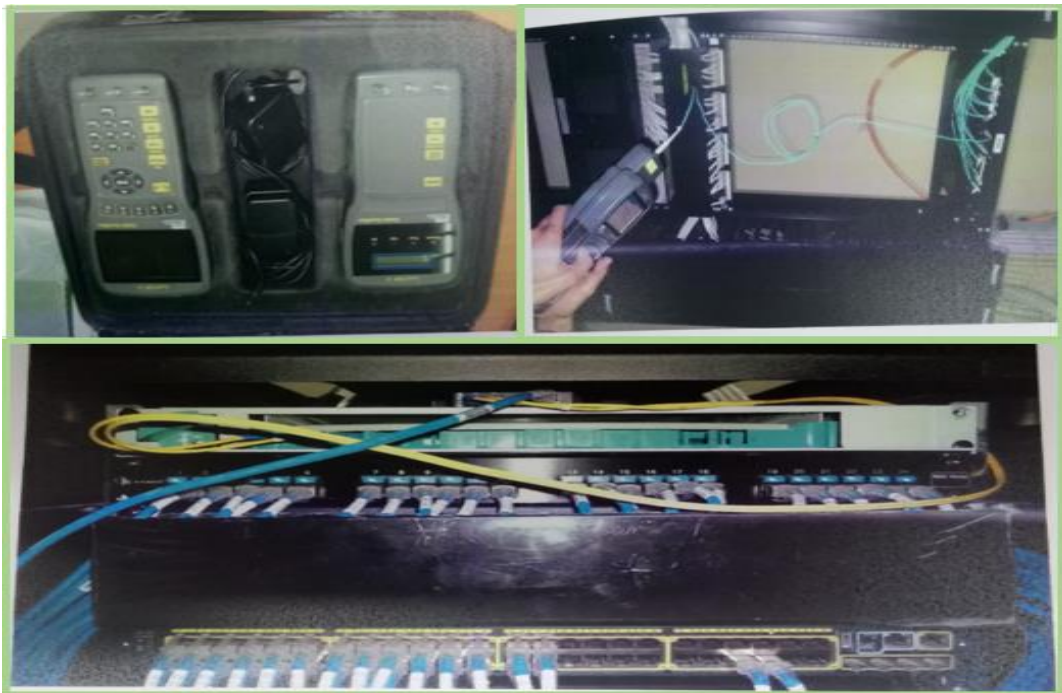
Figura 4.7 Pruebas de funcionamiento
