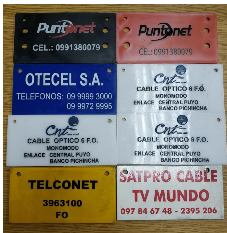
Figura 4.4. Etiquetas de cable
