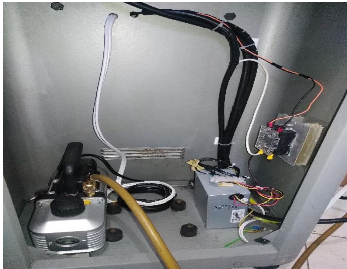
Figura 4.46. Instalación parte trasera
