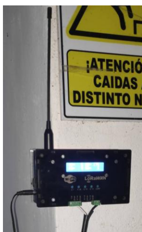
Figura 4.14 Instalación nodo Transmisor TX
