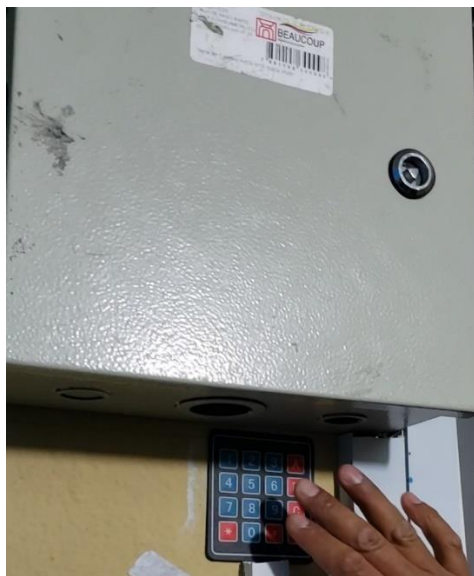
Figura 4.16. Teclado para ingreso de clave para apertura de puerta
