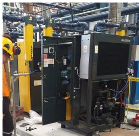
Figura4.17 EquiposSecadores Instalados Fuente (Autor)
