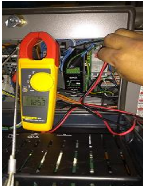
Figura 4.23 Pruebas de eléctricas Fuente (Autor)
