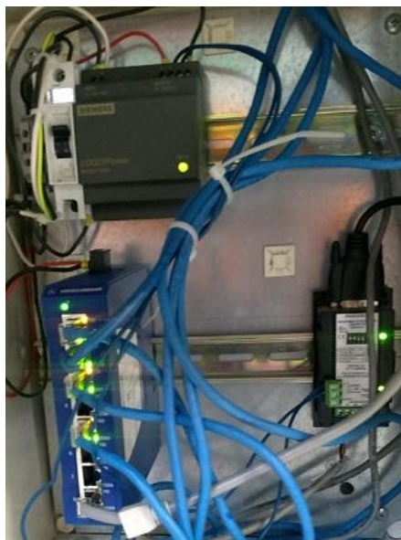
Figura 4.9 Tablero de Comunicaciones Fuente (Autor)
