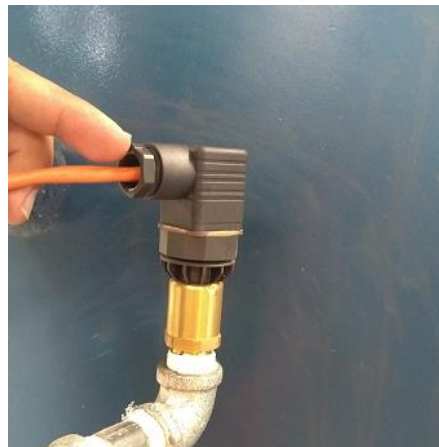
Figura4.16 Presentaciónsensor de Presión en Tubería Fuente (Autor)
