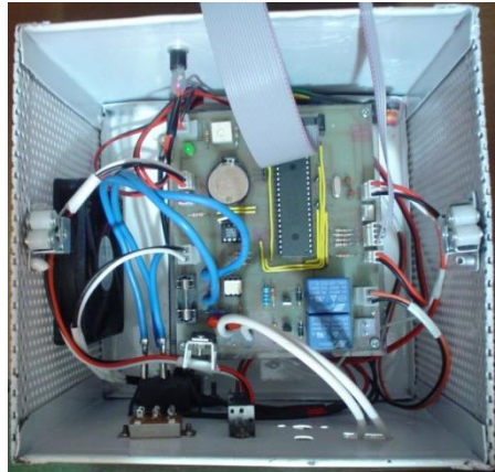
Fig. 56 Dispositivo de Control (Parte interna de la caja metálica)
