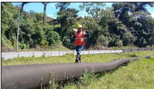
Acción subestándar. Caminar por superficies resbalosas. Personal expuesto a caídas a distinto nivel.
