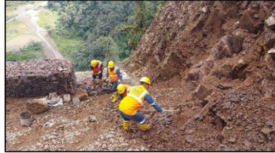
Condición subestándar. Inestabilidad del terreno, falta de señalización Personal expuesto a caída de objetos por desplome o derrumbamiento.
