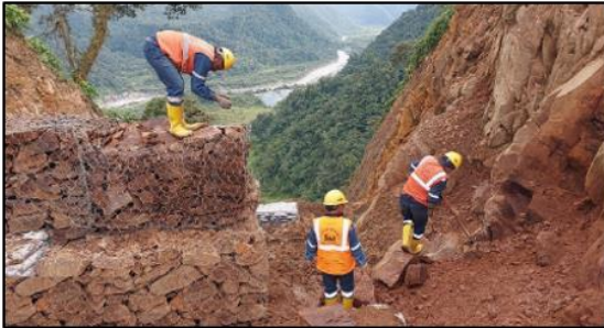
Acción subestándar. No utilización de EPP para trabajo en altura. Personal expuesto a caídas a distinto nivel.
