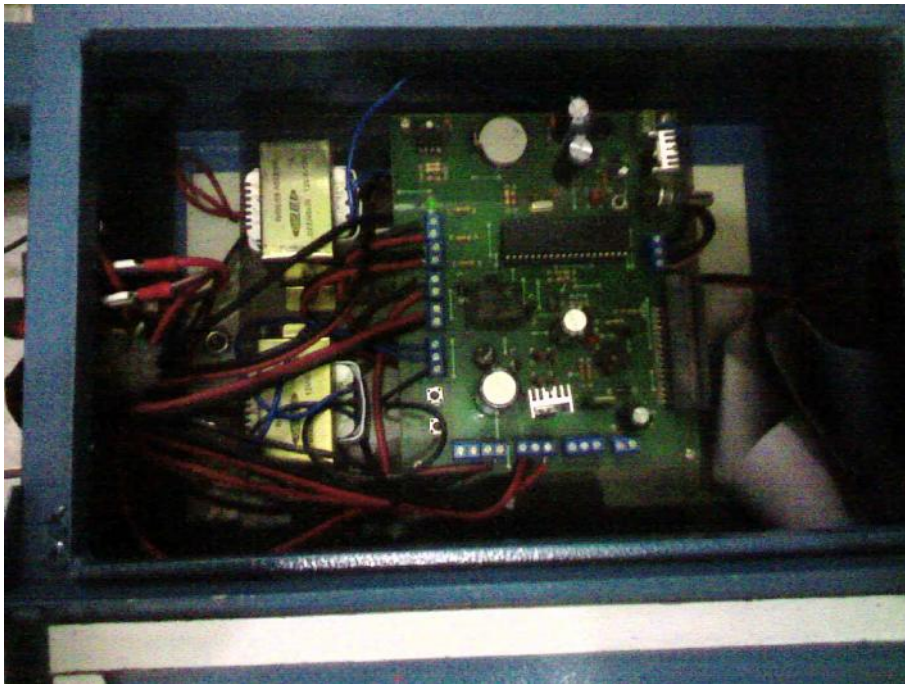
Figura 34 Dispositivo de Control (Parte interna de la caja metálica)
