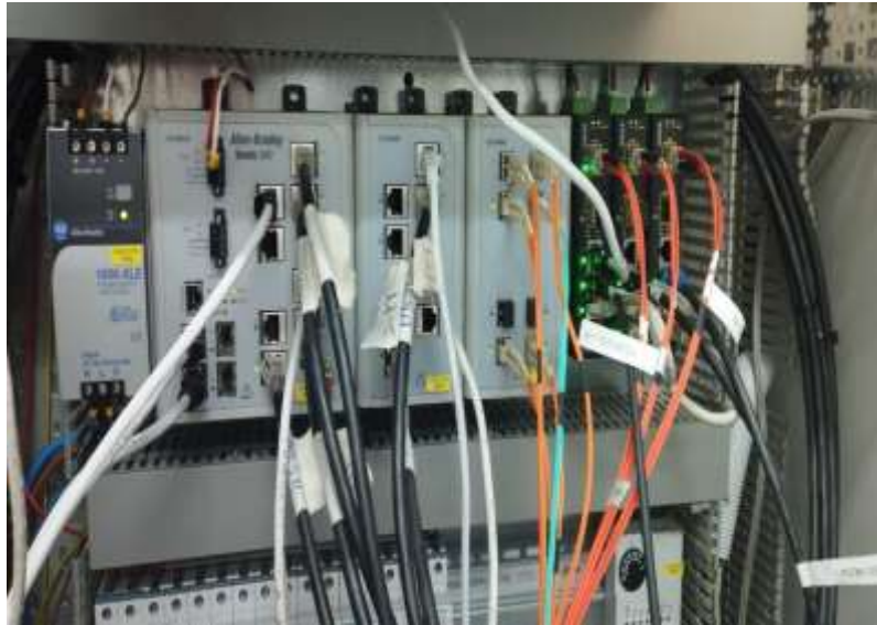
Figura 3. Conexión de los medidores hacia el switch
