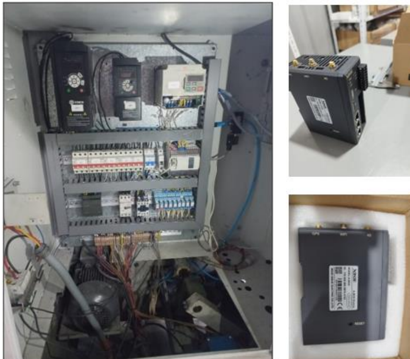
Estado actual de gabinete
