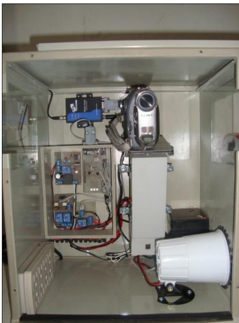
Figura 3.30 Montaje del sistema en la caja metálica
