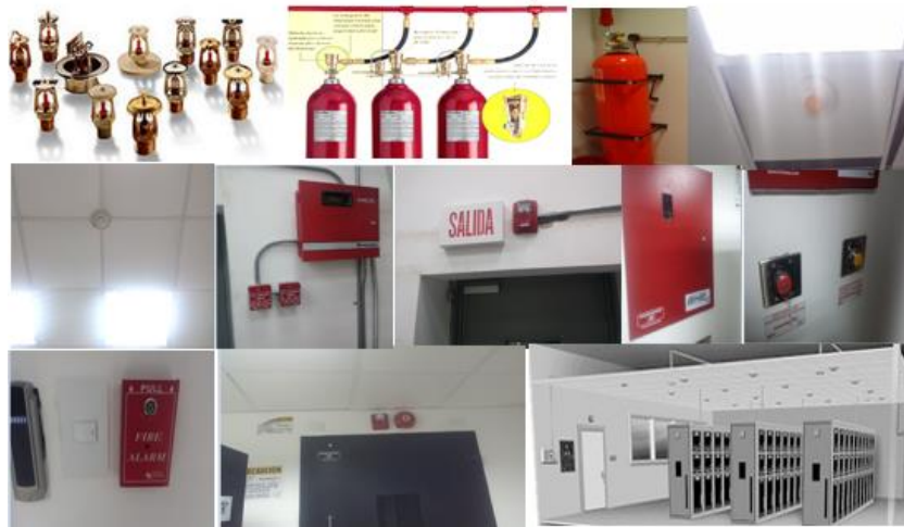
Ilustración 3.30: Sistema de detección y extinción Fuente: Elaborado por el Autor
