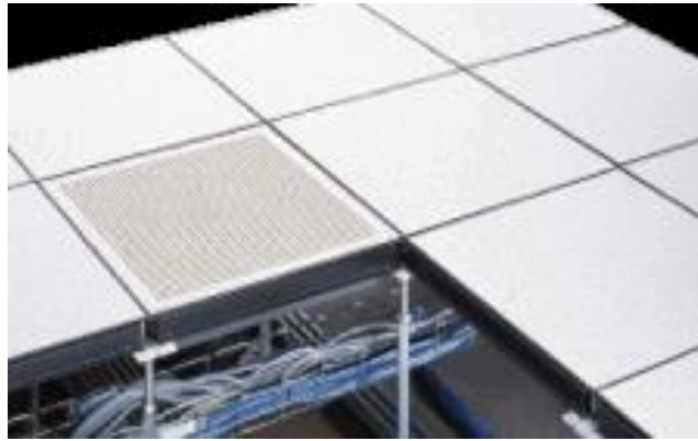
Ilustración 3.24: Piso falso palmeta perforada, para colaborar con pasillos fríos y calientes en el Centro de Datos
