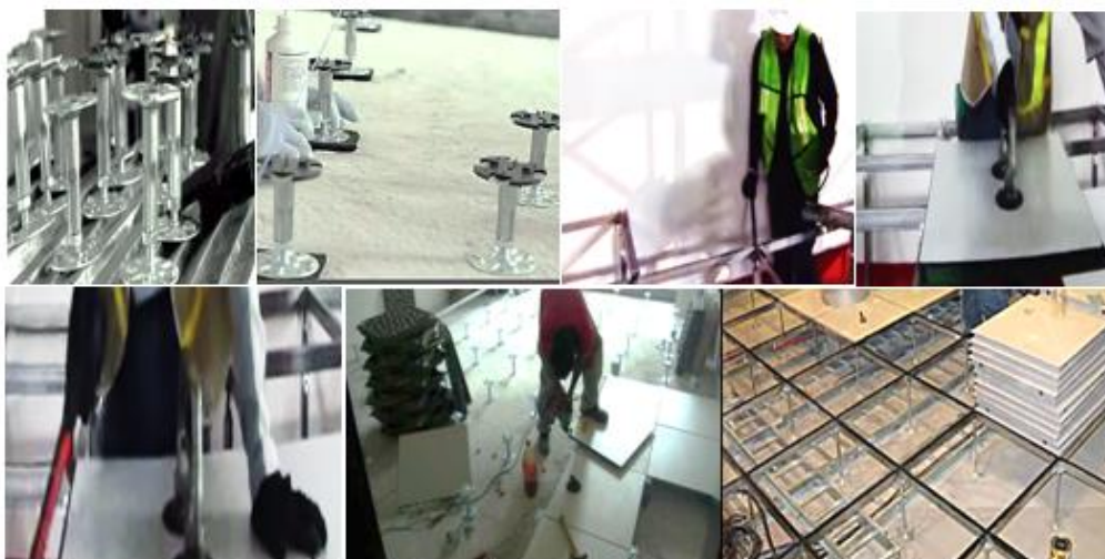
Ilustración 3.23: Piso falso, Cableado estructura y conexiones del cableado bajo el piso falso Fuente: Elaborado por el Autor
