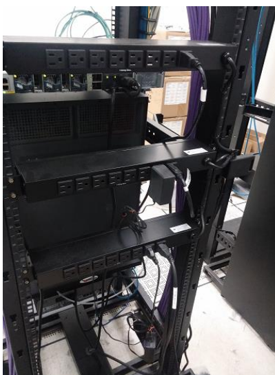
Ilustración 3.21: PDU de Racks Fuente: Elaborado por el Autor
