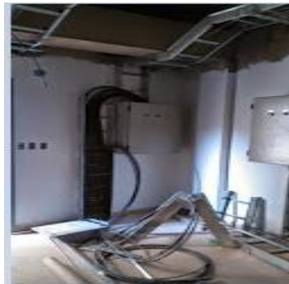
Ilustración 3.12: Acometida trifásica en el centro de datos
