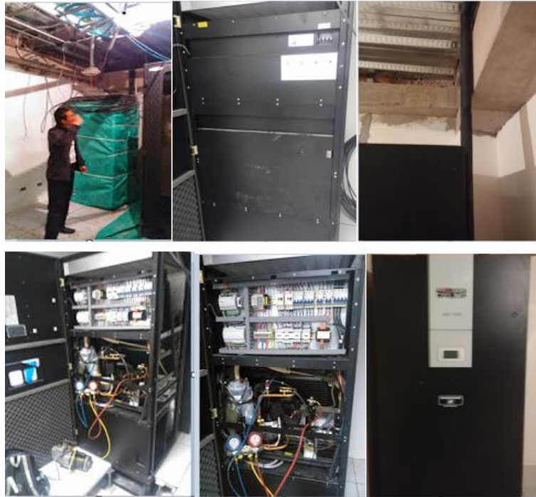
Ilustración 3.32: Aire Acondicionado de precisión Fuente: Elaborado por el Autor
