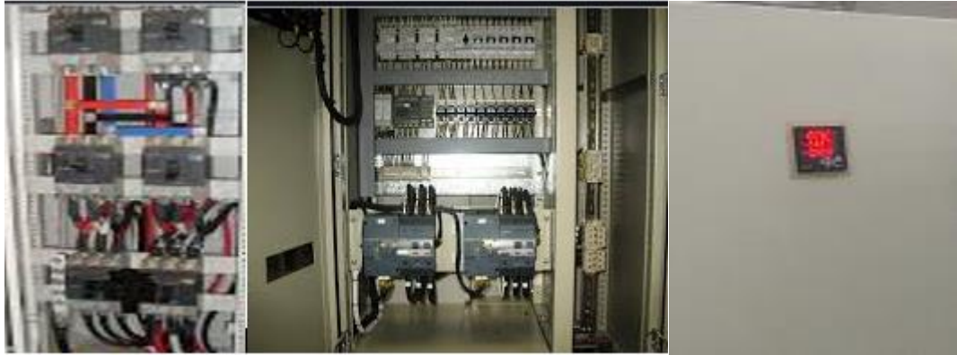
Ilustración 3.14: Tablero de Distribución centro de datos
