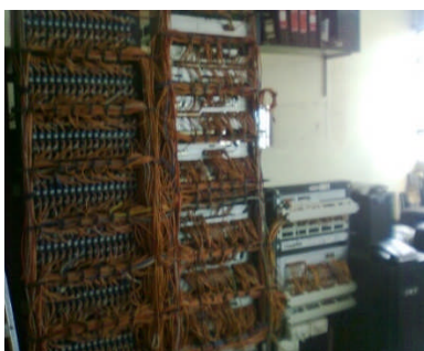
Figura 3.5: Implementación de central ALCATEL OMNI PCX ENTERPRISE
