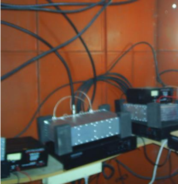
Figura 3.8 Equipos de Repetición
