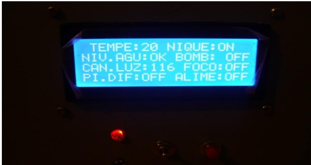
Figura 88: Foto del estado OFF en la bomba de agua
