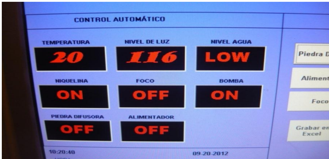
Figura 90: Foto del estado de la bomba de agua en el monitor
