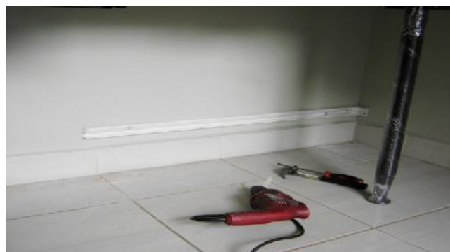
Figura 3.1.2.3 Canalización Externa centro TIC en FUDIS Realizado Por: Pamela Murgueitio.
