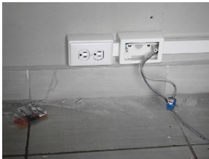
Figura 3.1.2.5 Cableado de Red Realizado Por: Pamela Murgueitio.
