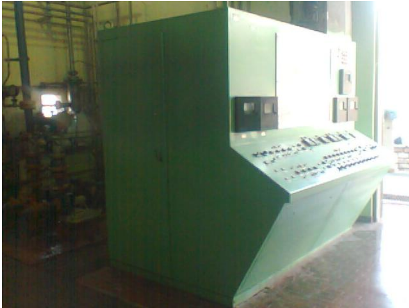
Figura 43.- Cuarto de Control
