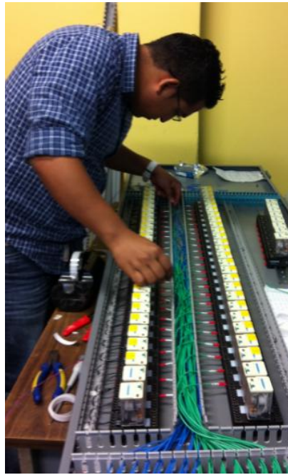
Figura 47. Cableado de salidas
