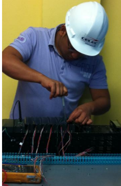
Figura 48. Cableado de finales de carrera.
