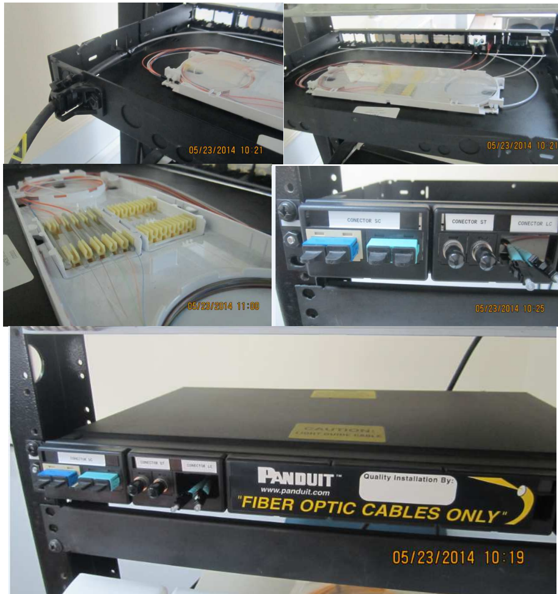
Figura 3.31 Instalación del ODF en el Rack A 47
