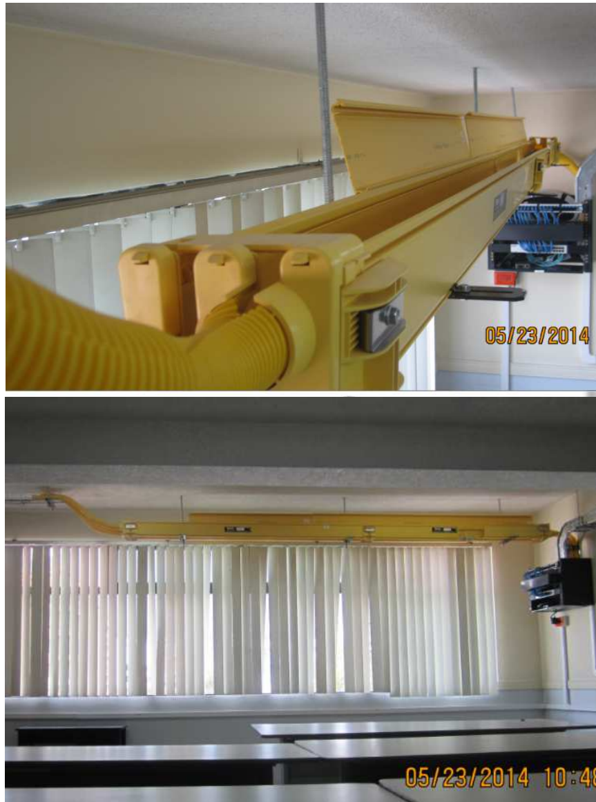
Figura 3.19 Fiber runner instalado acorde a las normas de cableado estructurado 38
