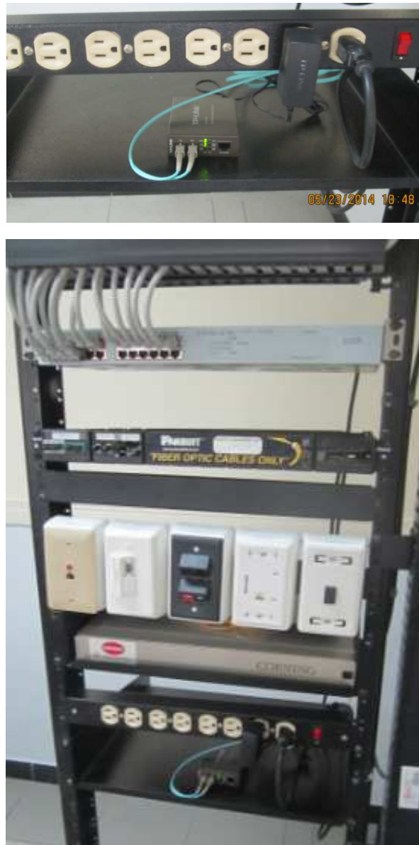
Figura 3.33 Cable de fibra MM-OM3 conectado al conversor RACK A49
