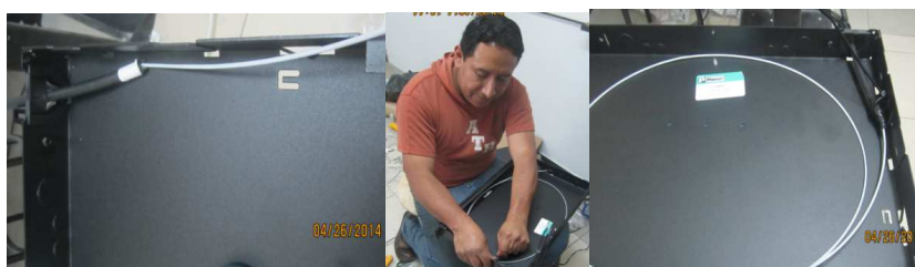
Figura 3.22 Ingreso del cable Externo hacia el ODF 41
