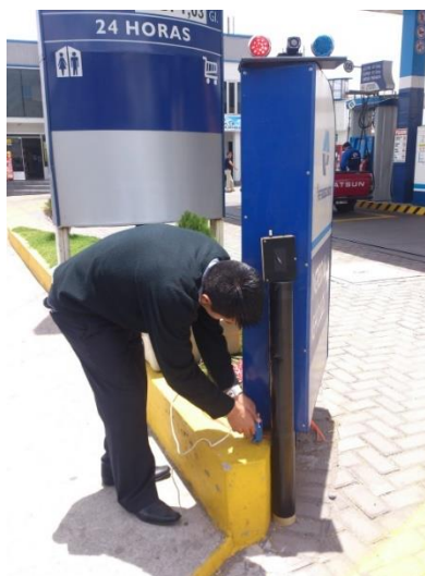
Fig. 3.40 Instalación del DIV en la Estación de servicios PETROECUADOR.
