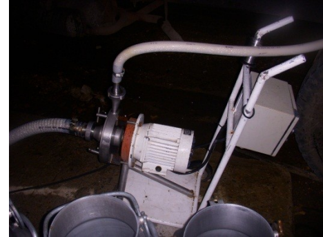
Bombas manuales para descarga
