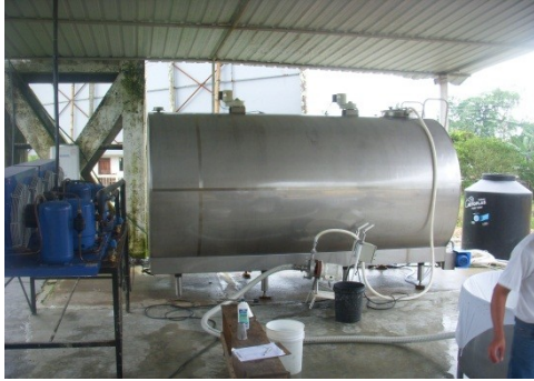
Tanques provisionales de descarga
