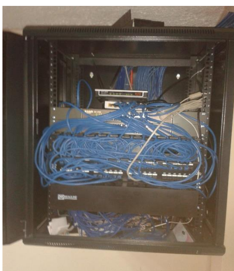
Imagen 1 Ubicación Rack de Comunicaciones Planta Baja
