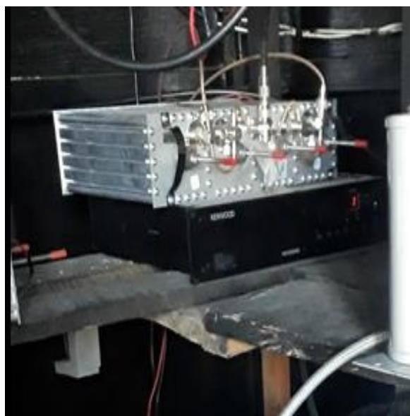
Figura: 4.6. Fotografías del duplexor y repetidor
