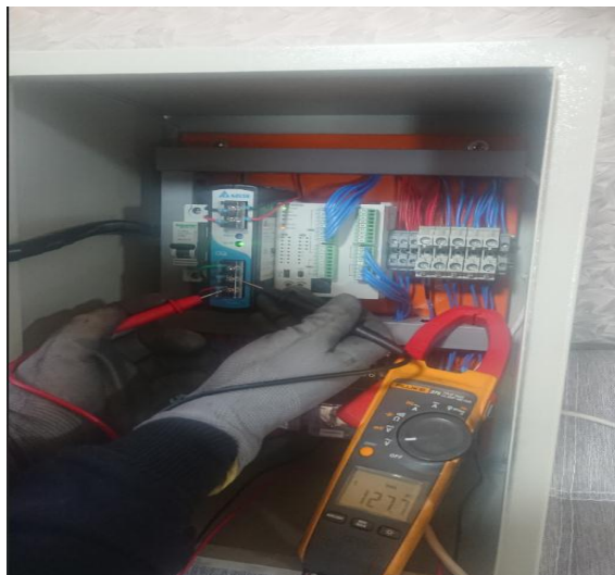
Figura 4.19 Pruebas de eléctricas Fuente (Autor)
