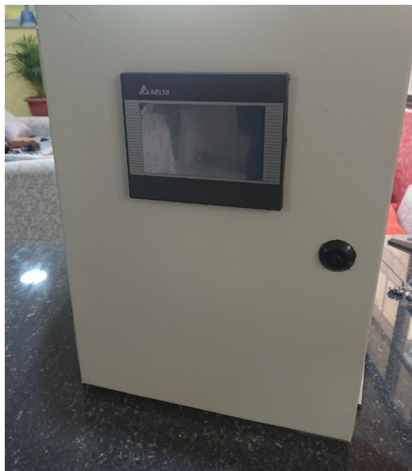
Figura 4.21 Instalación HMI Fuente (Autor)
