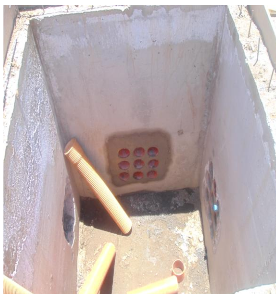
Figura 3.17. Ductos para FO.
