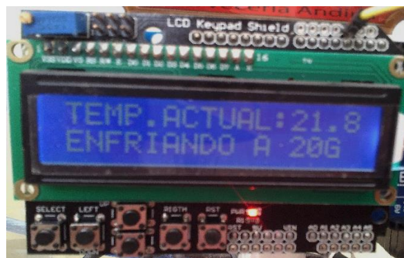
Figura 51. Temperatura del mosto en el tanque y valor de la temperatura a ser enfriado el mosto.
