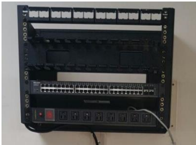
Figura 3.10 Instalación de Rack y dispositivos (Israel, 2017)
