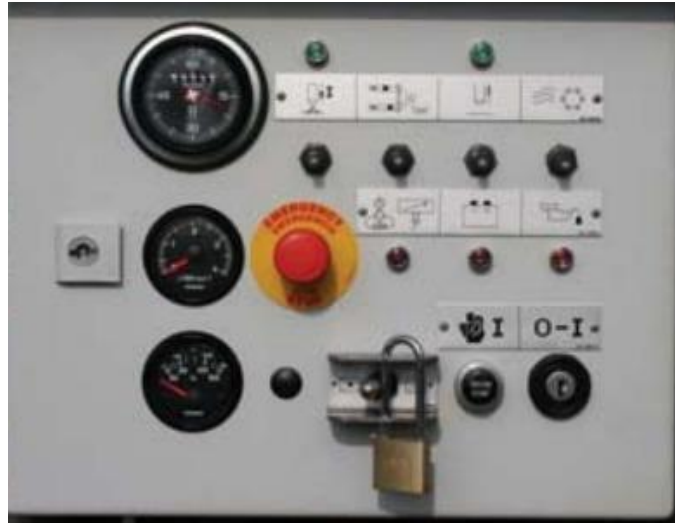
Figura. 13 Tablero de control Fuente: autor
