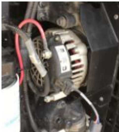
Figura. 11 Alternador instalado en el motor de combustión interna Fuente: autor
