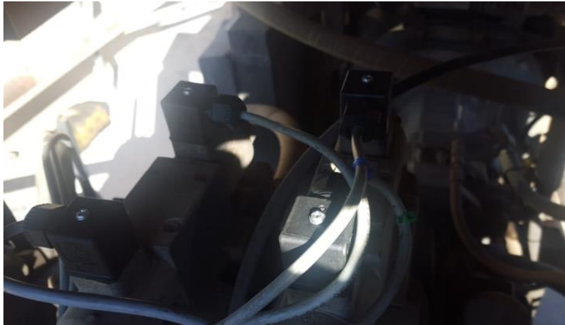
Figura. 33 Conexión de electroválvulas sobre el bloque hidráulico principal Fuente: autor
