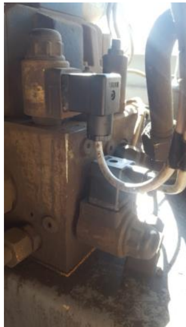
Figura. 32 Conexión de electroválvulas de presurización del sistema hidráulico Fuente: autor
