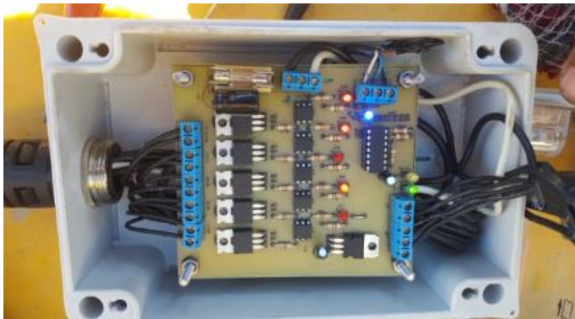
Figura. 37 Arnés de emergencia activado la función de bombeo Fuente: autor
