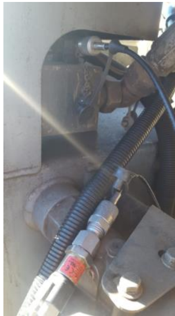
Figura. 34 Conexión del sensor de presión en el bloque de control de presión Fuente: autor
