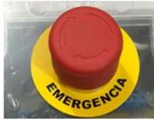
1. Pulsador de emergencia
