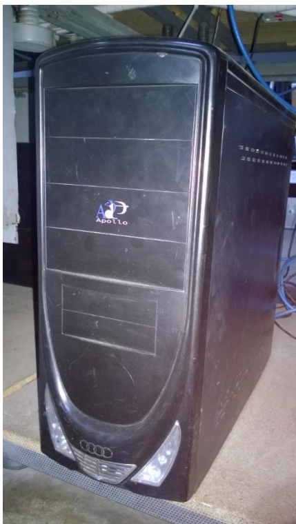
Figura. 4.52. Servidor ubicado en el área de Sistemas
