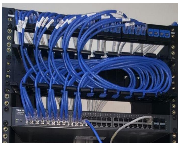
Figura. 4.15. Conexión de Patch Panel y Switch
