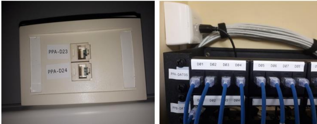
Figura. 4.15. Etiquetado del Cableado Estructurado
