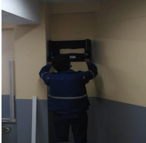
Figura. 4.9. Montaje del Rack. Fuente: Elaborado por el Autor
