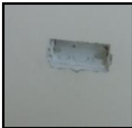
Figura 4.10. Cajetín y manguera Fuente: (Jínez, 2019)
