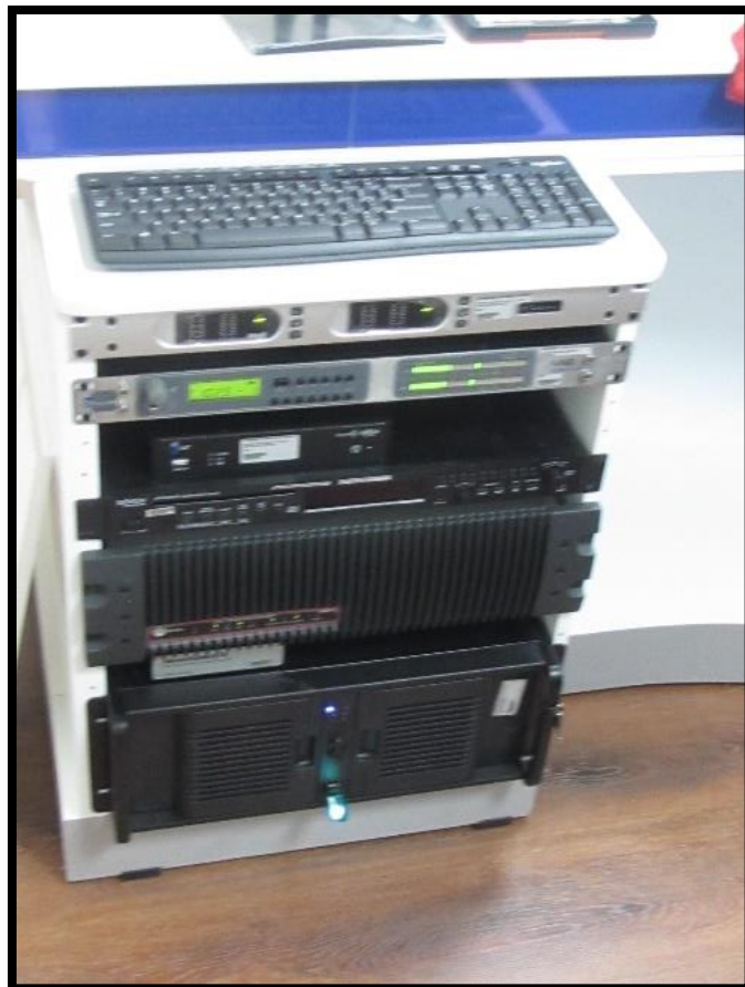
Figura 4.15. Ubicación de los equipos Fuente: (Jínez, 2019)
