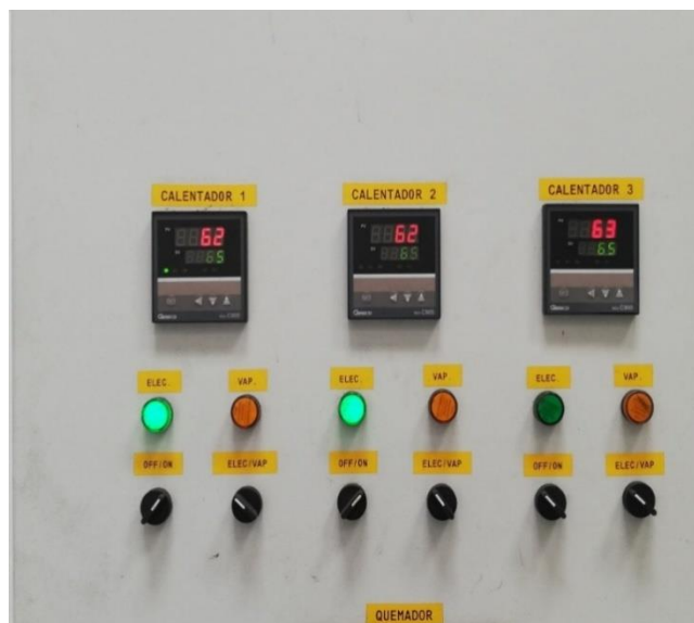
Figura 4. 16 Temperatura de calentadores eléctricos
