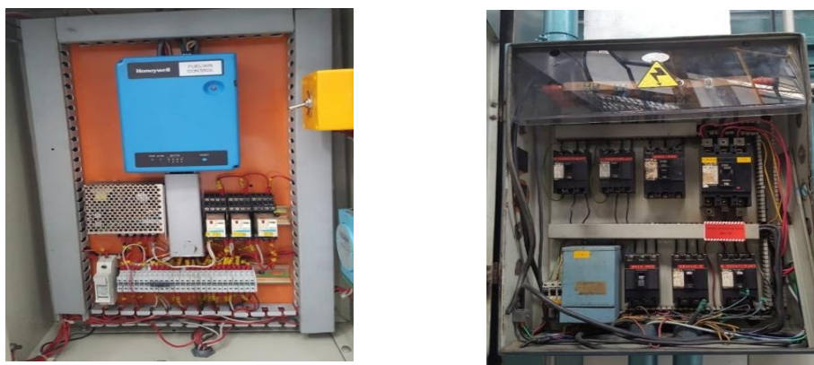
Figura 3. 4 Paneles eléctrico y de control para la caldera
