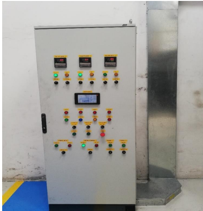
Figura 4. 13 Tablero de control de la caldera cuatro
