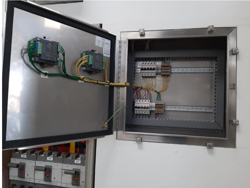
Cableado de dispositivos electrónicos
